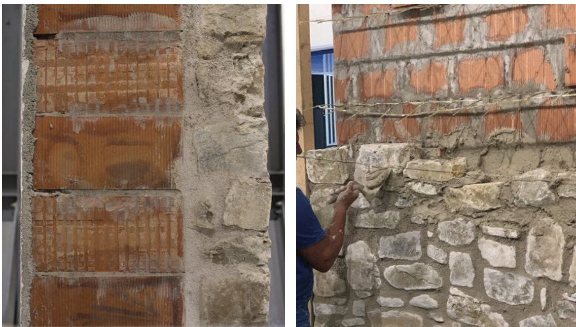
Fig. 1 - La soluzione tecnologica sviluppata per la ricostruzione post-terremoto consiste in una struttura composta dalla muratura armata POROTON® sul lato interno e dalla muratura in pietrame di recupero facciavista esterna opportunamente connesse anche con l'impiego di reti Fibre Net.
